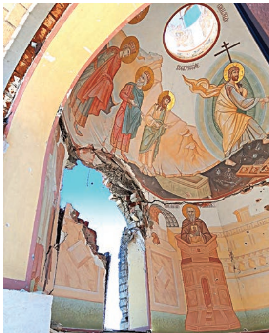
Фрагмент разрушений в Успенском соборе
